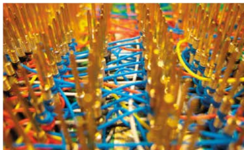
Rysunek 3.37. Połączenia owijane w zbudowanym przez Steve'a Chamberlina 8-bitowym procesorze i komputerze. Stworzenie takiej sieci połączeń w tamtych czasach przy użyciu lutowania byłoby niezwykle czasochłonne i podatne na błędy. Zdjęcie zaprezentowane dzięki uprzejmości Steve'a Chamberlina
